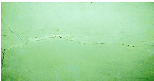
Fig. 3. (b) Thin crack (<1mm)
